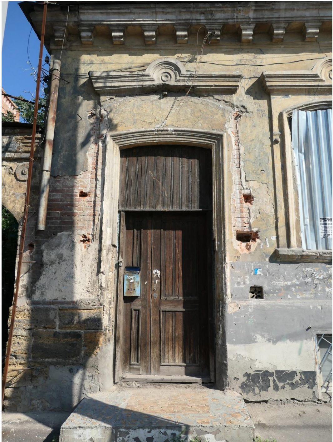
6. Ростовская область, городской округ город Ростов-на-Дону, город Ростов-на-Дону, ул. Московская, дом 41/27. Главный вход на парадном южном фасаде литера А, входящего в состав Объекта. Фото 04.07.2023 г.
